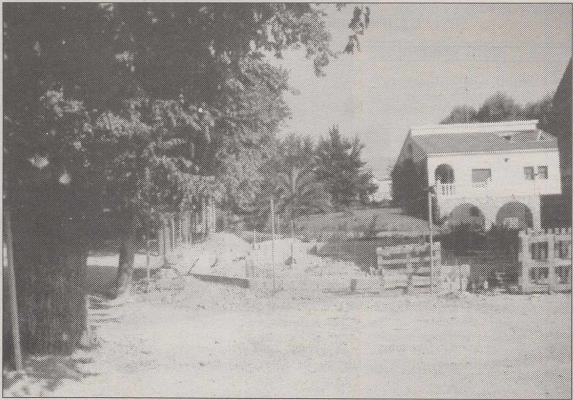
Se están efectuando obras que contravienen las ordenanzas.
