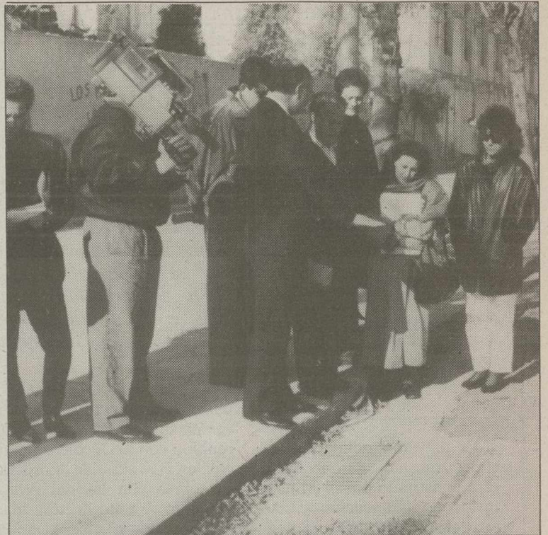
Las obras de canalización se han iniciado en el Paseo de la Cuba.
