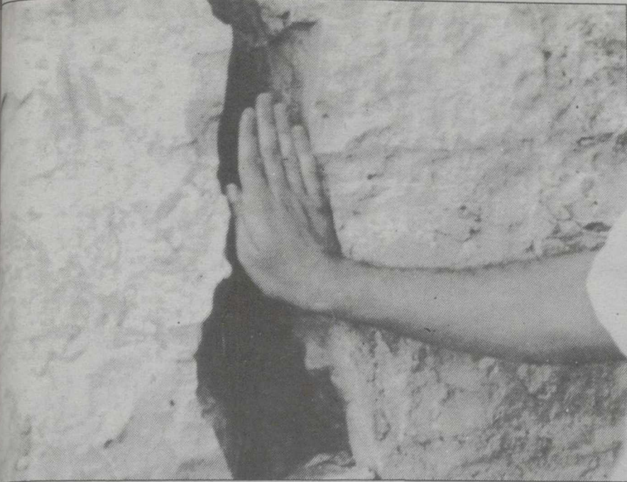
Imagen pueden verse las dimensiones de esta grieta situada en la cara norte de la muralla.
