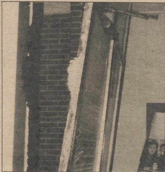
Estado en que quedó la puerta.
