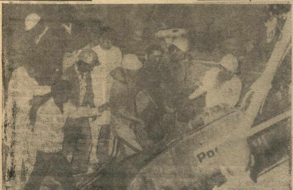
PAMPLONA.—Tres obreros han resultado muertos y otro más herido, al producirse un corrimiento de tierras en unas obras de excavación que se realizan en las afueras de la ciudad, para la construcción de un puente sobre el río Argá. El derrumbe alcanzó a varios de los obreros que trabajaban en el fondo de la zanja. (Foto EUROPA PRESS).
