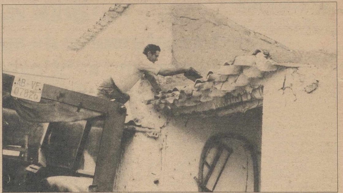
En septiembre, una aparatosa tormenta de piedra causó importantes daños en Tarazona.
