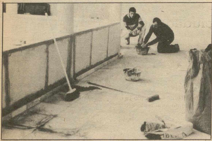
Los zócalos afectados por la humedad están siendo remozados a marchas forzadas.
