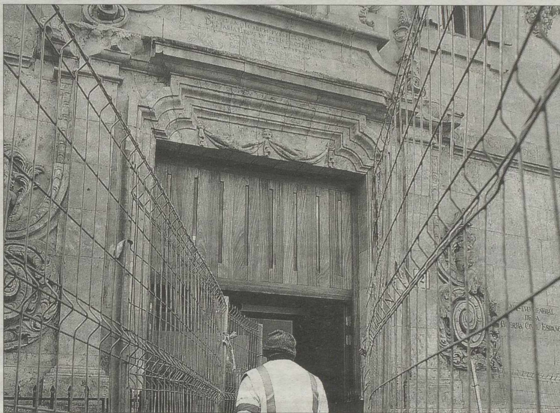
El edificio salmantino que alberga el Archivo aparecía ayer rodeado de vallas de obra. / DAVIZ ARRANZ (ICAL)
