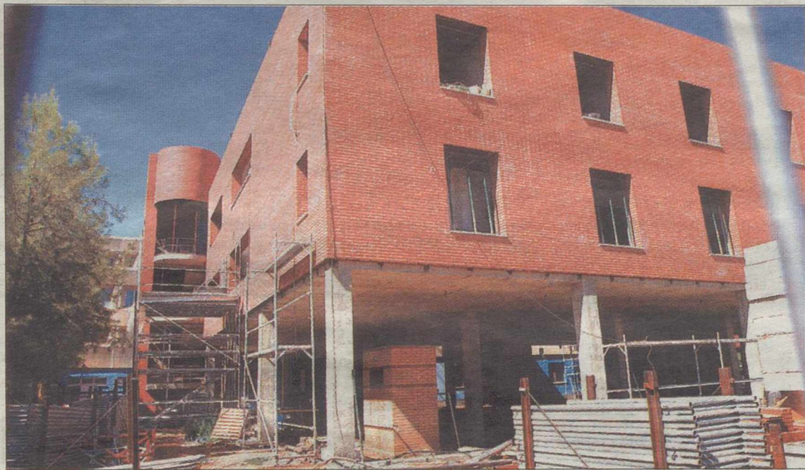
En este edificio irán ubicadas la Unidad de Cuidados Intensivos y las nuevas consultas. / PILAR G. MANZANARES
