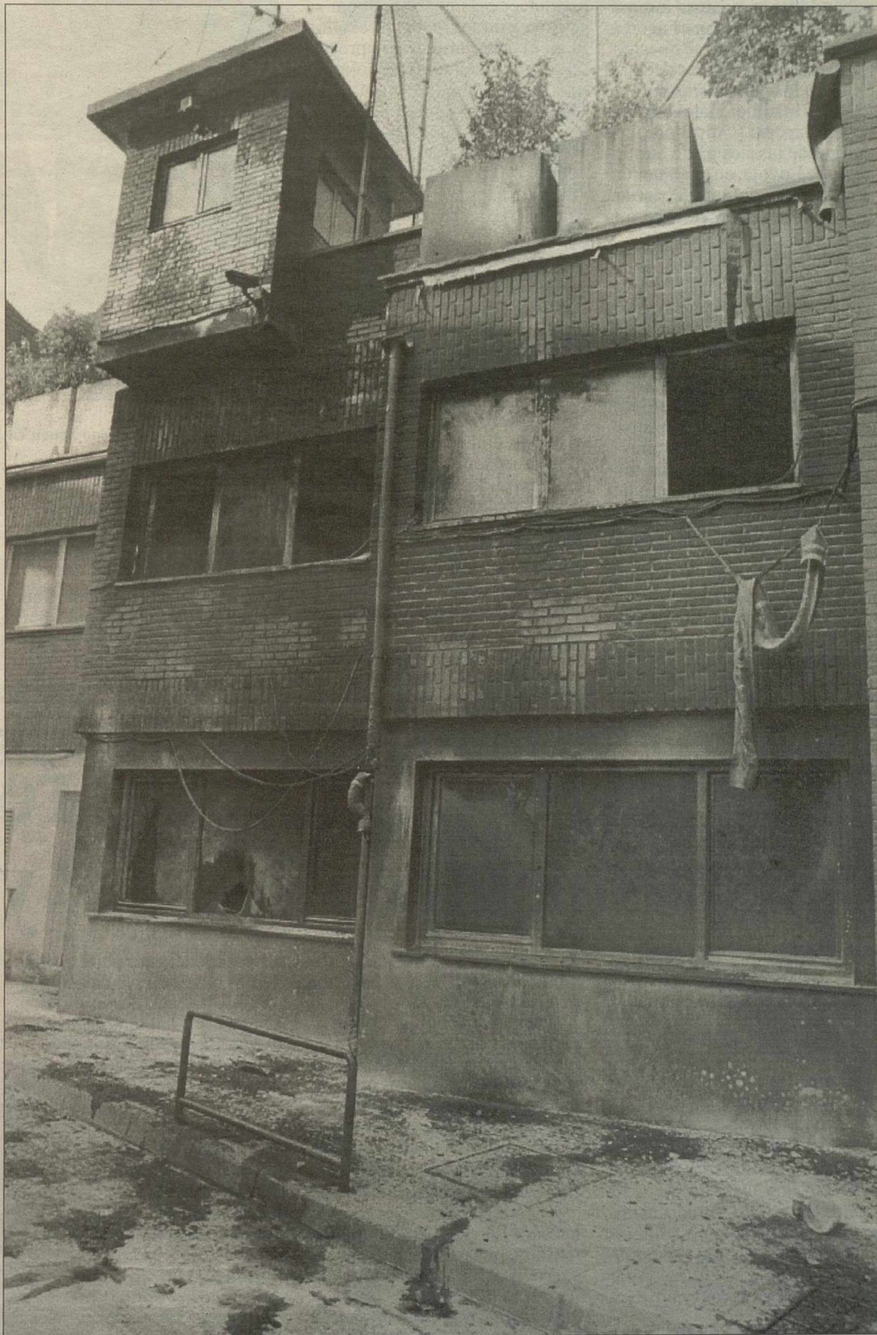
Estado en que quedó la fachada de la Casa Cuartel de Guecho.
