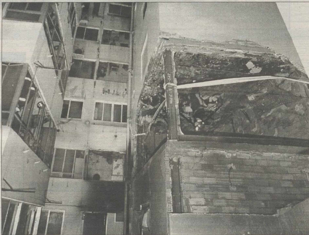
El incendio de la vivienda se propagó por el inmueble.
