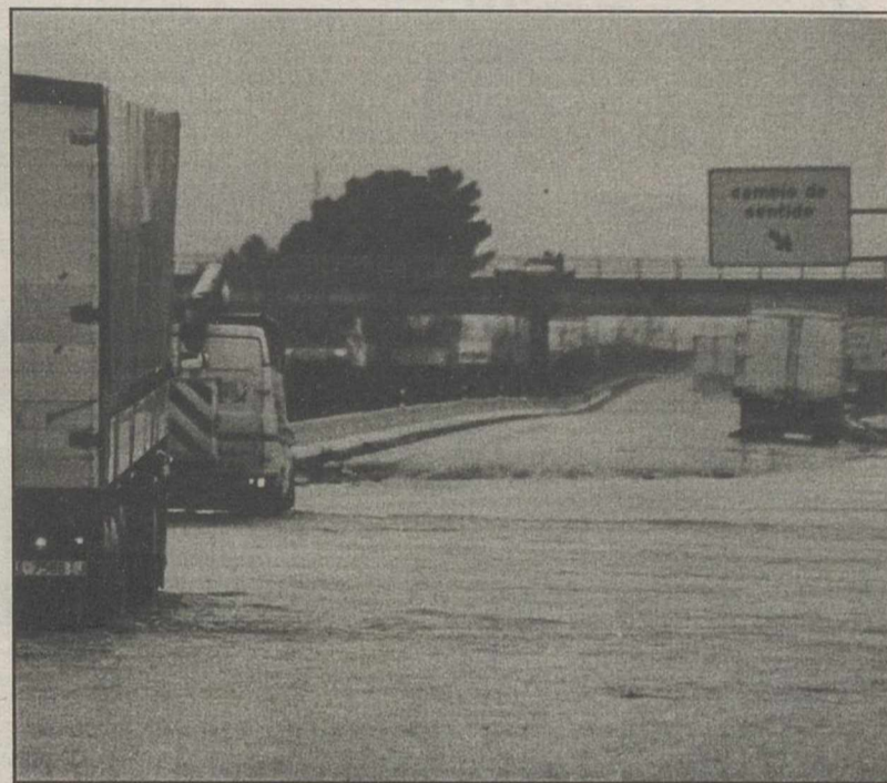
La acción del agua ha deteriorado bastante el firme en ese tramo.
