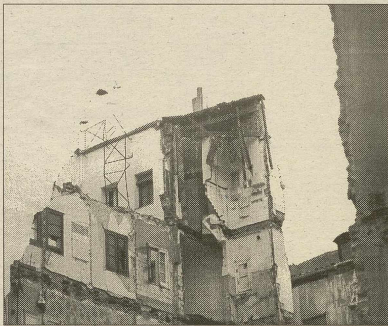
El derrumbamiento afectó principalmente a la parte derecha.
