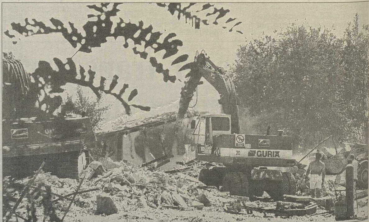
La demolición de El Pilar, ultimada. Las labores de demolición del colegio de El Pilar, que se inició el pasado jueves 31 de julio, están tocando a su fin. Este terreno será ofrecido por el Ayuntamiento de Ciudad Real al Ministerio de Educación y Cultura para construir el nuevo instituto Maestro Juan de Avila. En la imagen de M. Cieza, las máquinas recogen material de la obra demolida.
