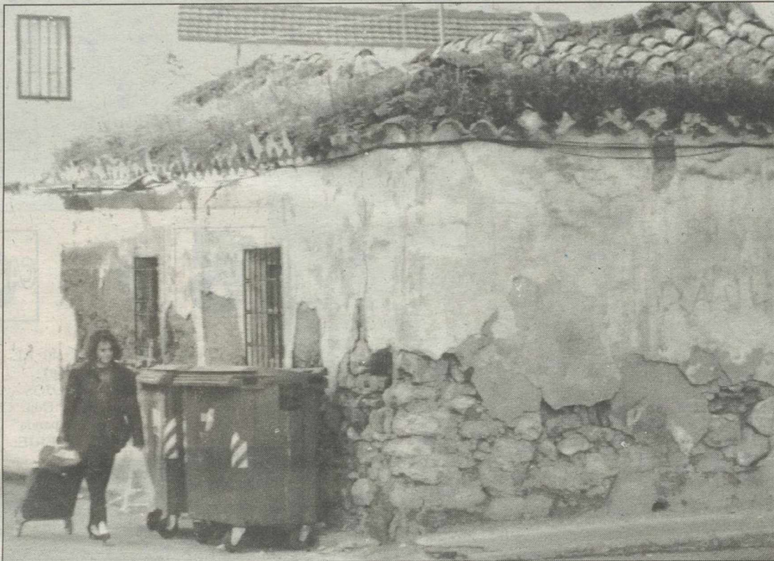
Casa en ruinas. La casa que muestra la imagen puede verse en la calle Real de la capital, concretamente en su número 23. El estado de extrema ruina que presenta hace pensar en posibles desprendimientos que podrían causar desgracias personales si no se toman a tiempo las medidas oportunas. Por ética y por estética, esta casa debería ser demolida.
