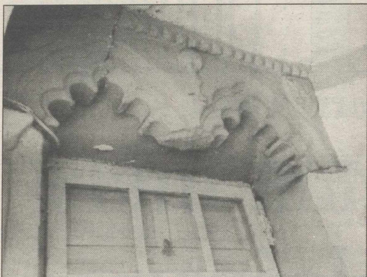
La ventana geminada no tiene la columna central.
