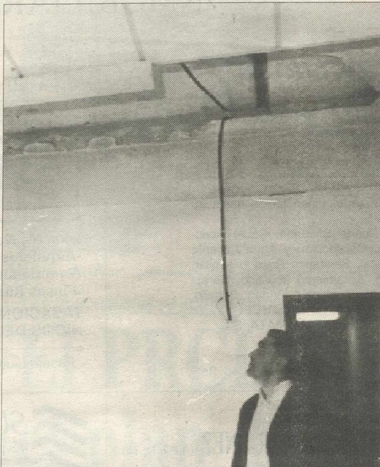
En un despacho del Conservatorio se cayó recientemente parte del techo P.G.M.
