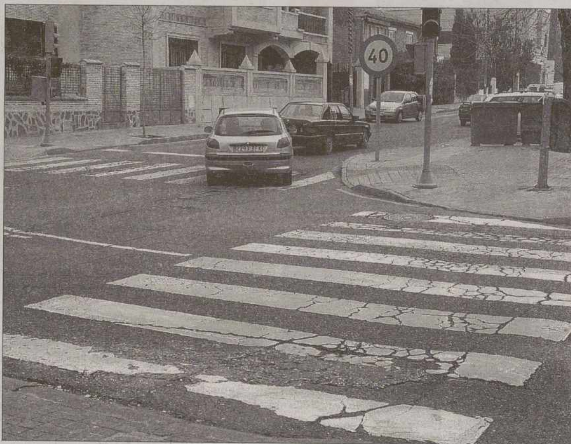
Tanto el firme de la acera como el de la carretera necesitan un repaso. / DAVID PÉREZ
