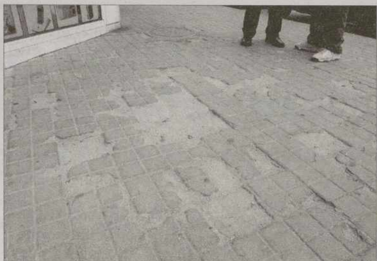
Acerado. El mal estado de las aceras sobresale en calles como Colombia o Coronel Baeza, pero es una constante en todo el barrio. Ya se han caído varias personas por su culpa. / D.P.
