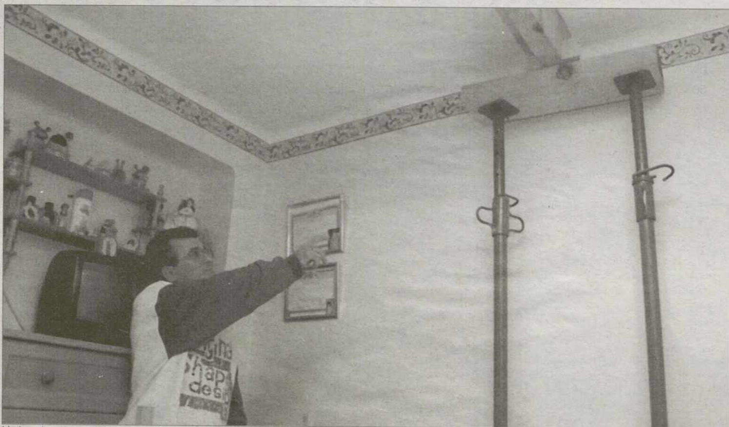
Un hombre muestra los desperfectos de su vivienda.
