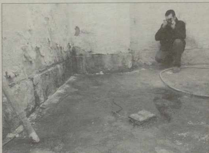
Las filtraciones pueden dañar seriamente a este monumento. / P. ZAMORA
