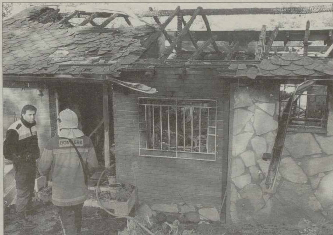
Estado en el que quedó la casa que se incendió en la localidad barcelonesa de Piera. / EFE
