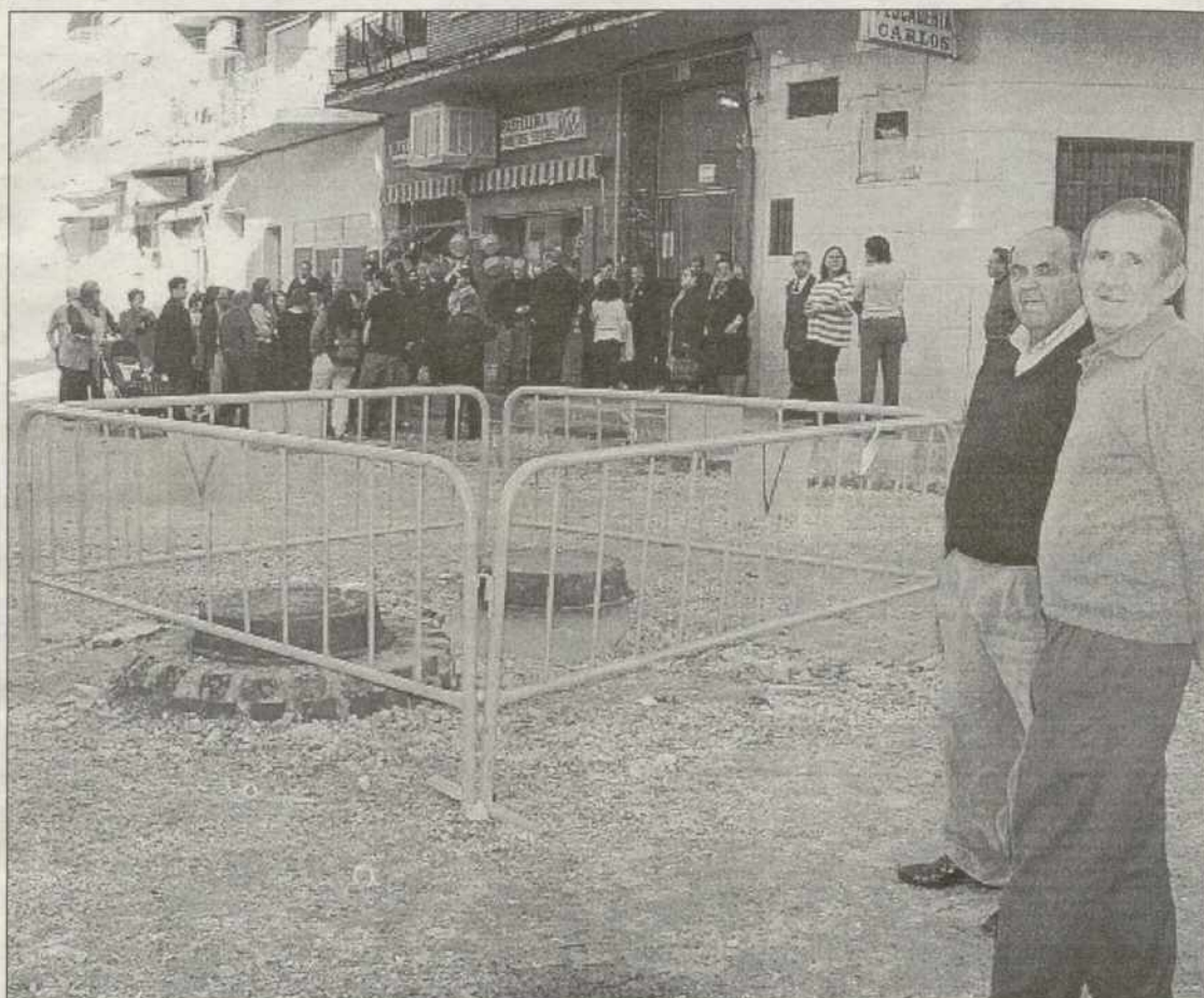
Calles levantadas es el panorama que afrontan los vecinos del Pilar y el paseo de la Estación
