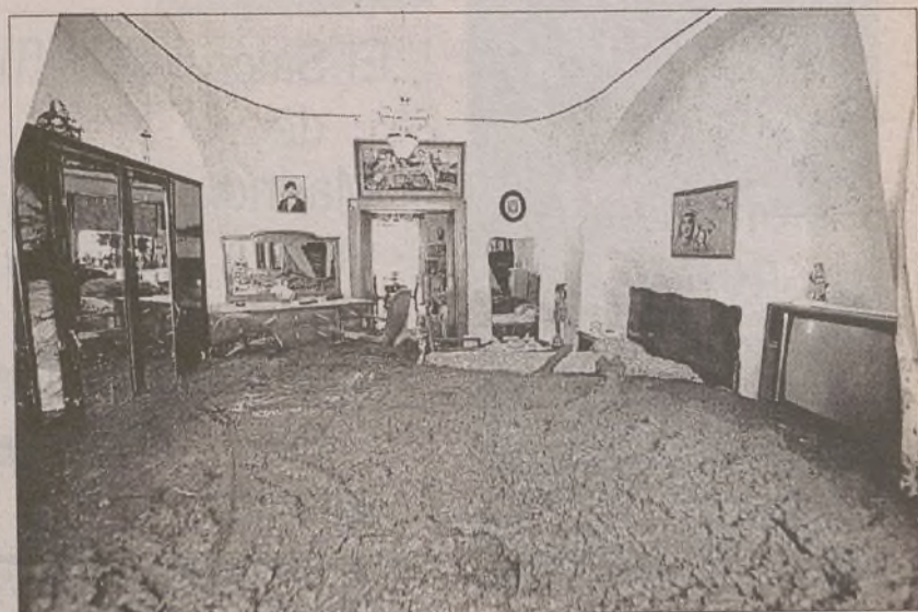
Aspecto de uno de los hogares destruidos por el lodo.
