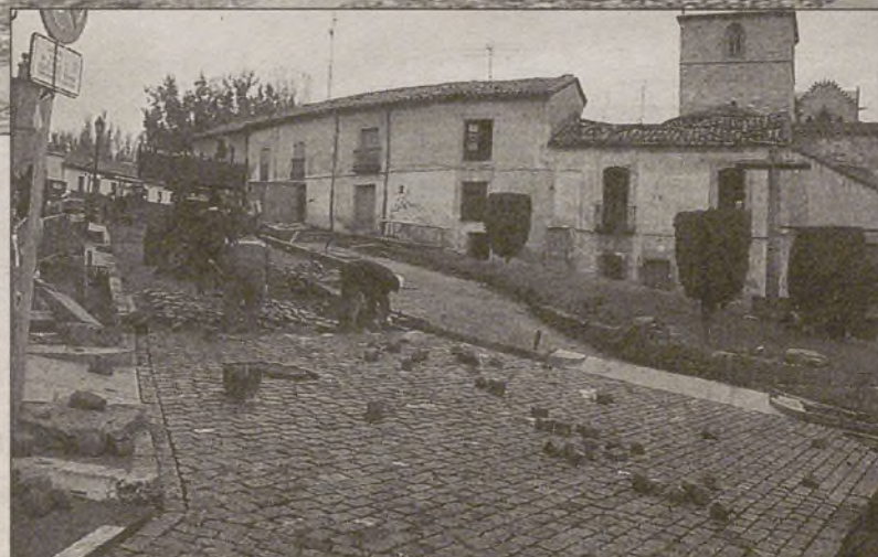
Edificios en ruinas de la calle Humilladero / ENRIQUE
