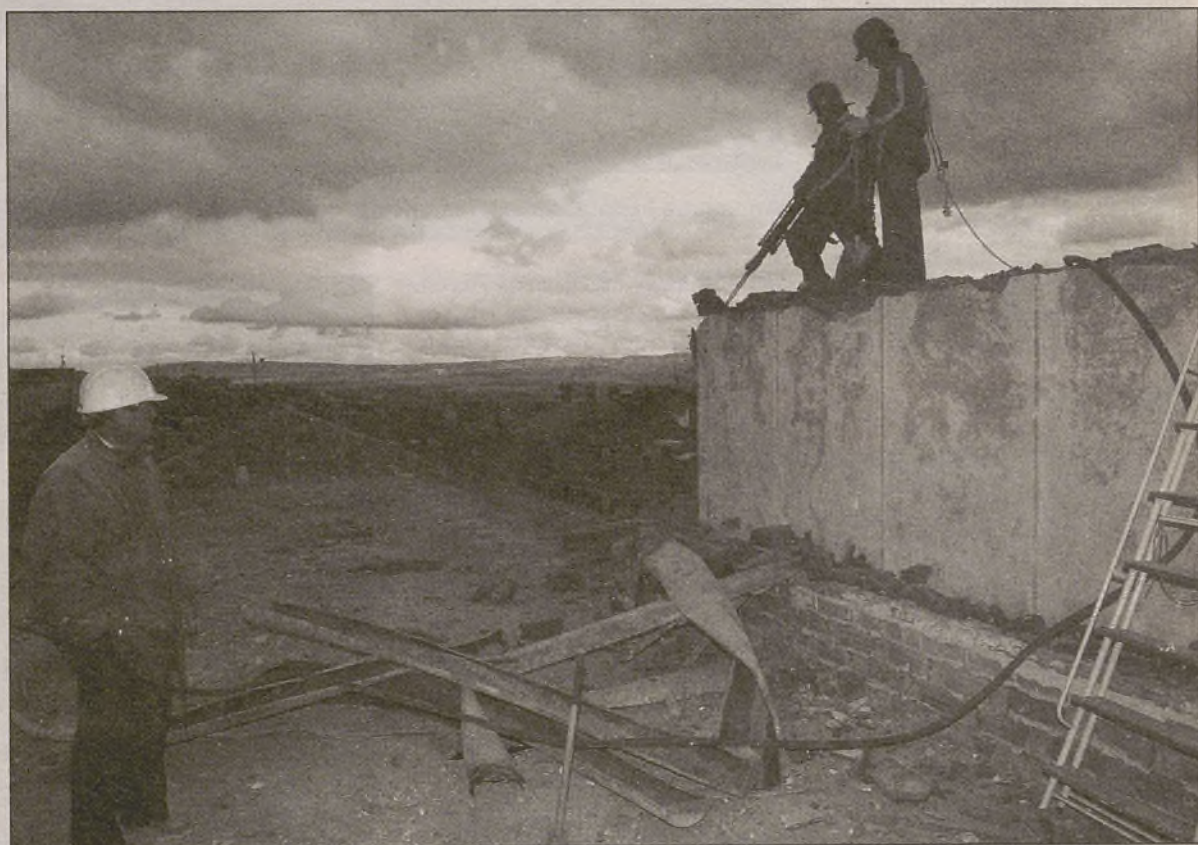
Imagen de los trabajadores que derriban el edificio central del lado sur del Mercado Grande / LUMBERIAS
