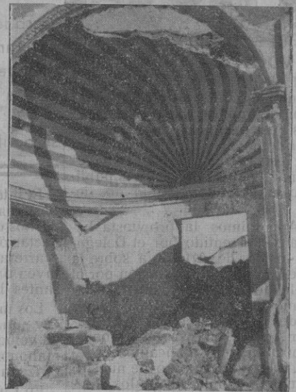
Una interesante foto tomada durante la demolición del convento. - Entrada a la iglesia de Sta. Clara. (Fot. Lluç)
