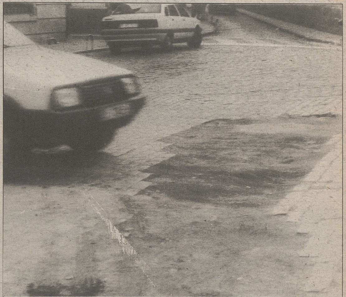
El mal estado de las vías impide la normal circulación.
