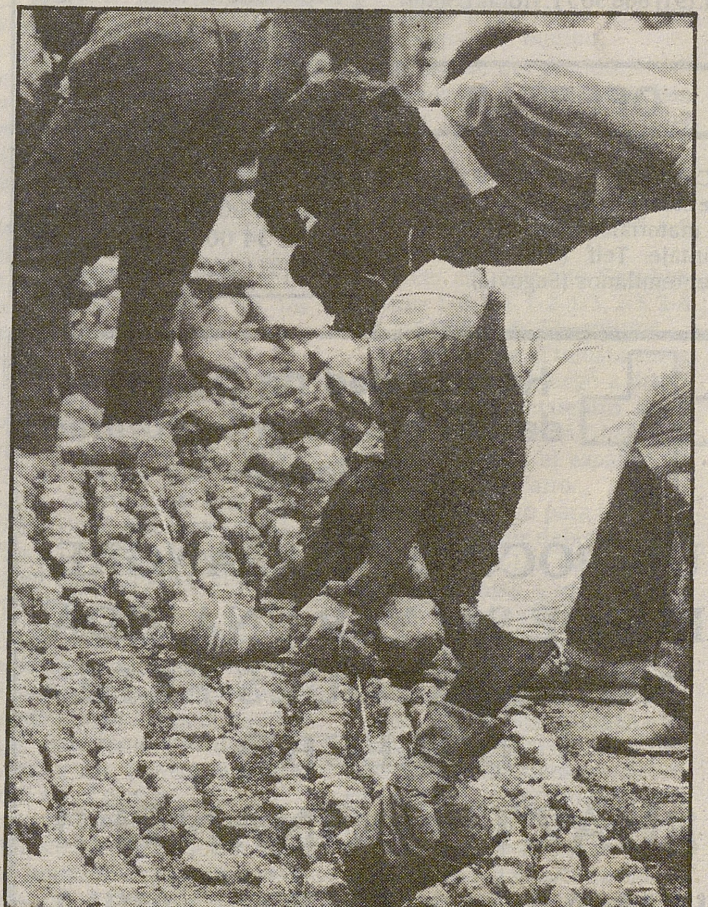
Con las tres calles en las que ahora se trabaja, el ochenta por ciento del casco urbano estará pavimentado.
