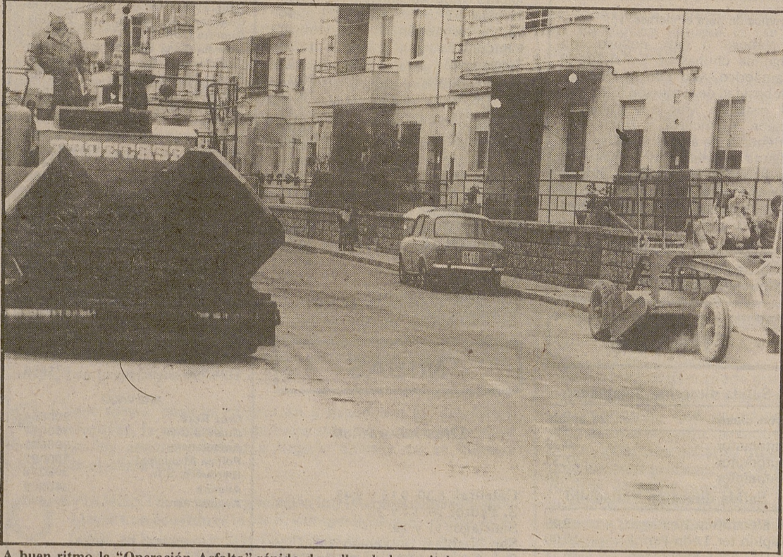
A buen ritmo la "Operación Asfalto" rápido de calles de la capital.
