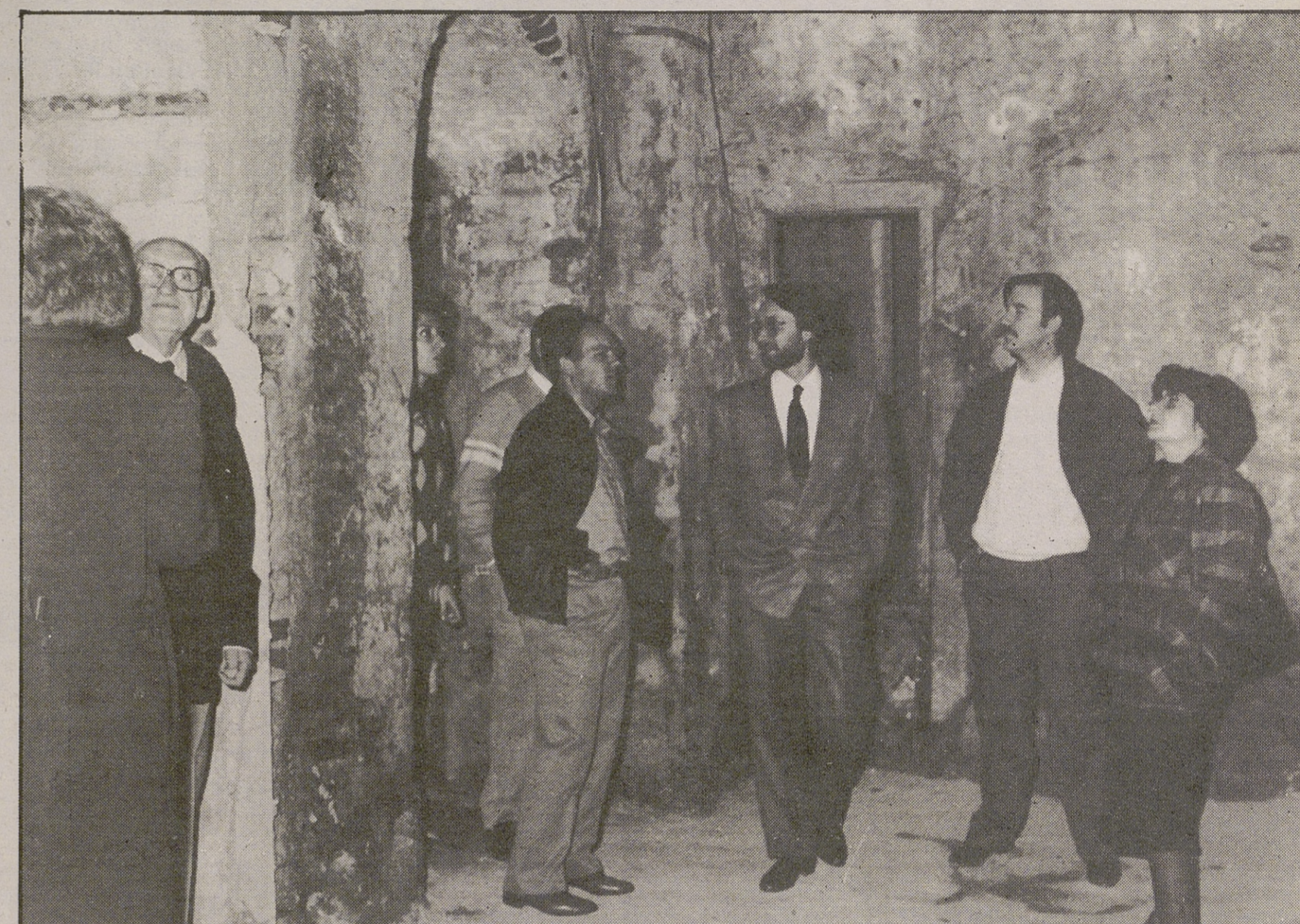
El arquitecto autor del proyecto, Enrique Redondo, muestra, en presencia de Maximiliano Fernández, redactor de EL DIARIO DE AVILA y del conocido industrial abulense Sr. Sánchez Cuesta, aspectos del estado actual del edificio del Teatro Principal.
