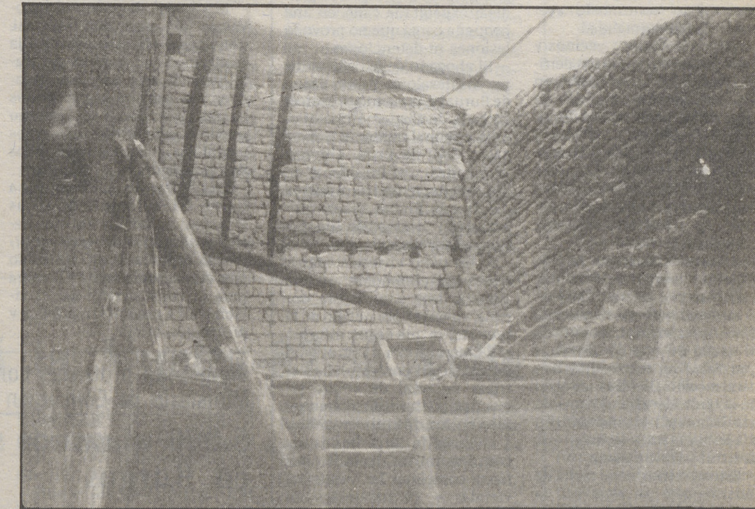
El incendio derrumbó el tejado por completo.
