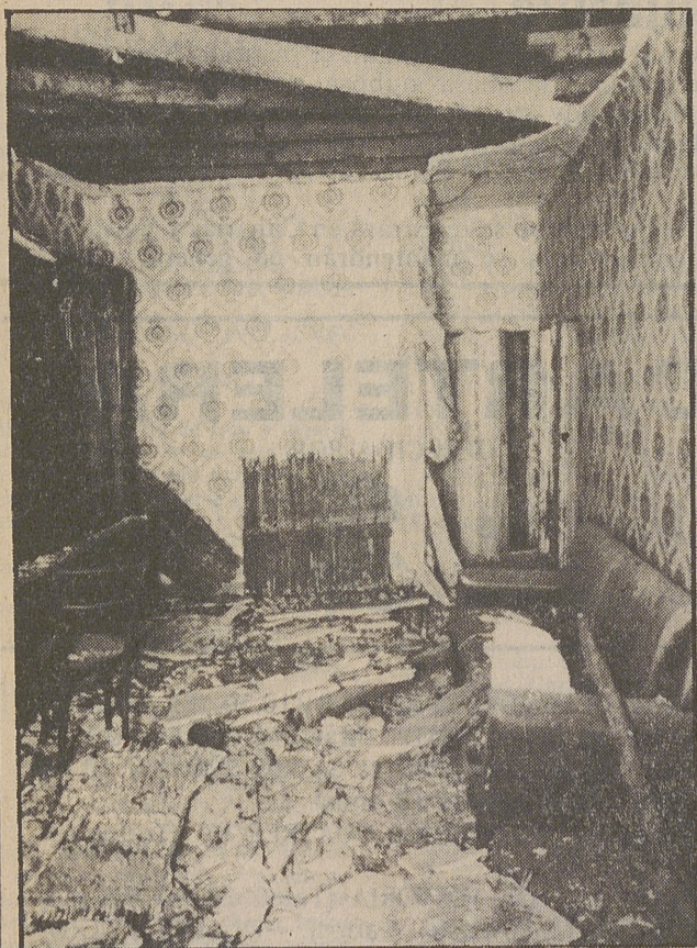
La vivienda quedó llena de escombros
