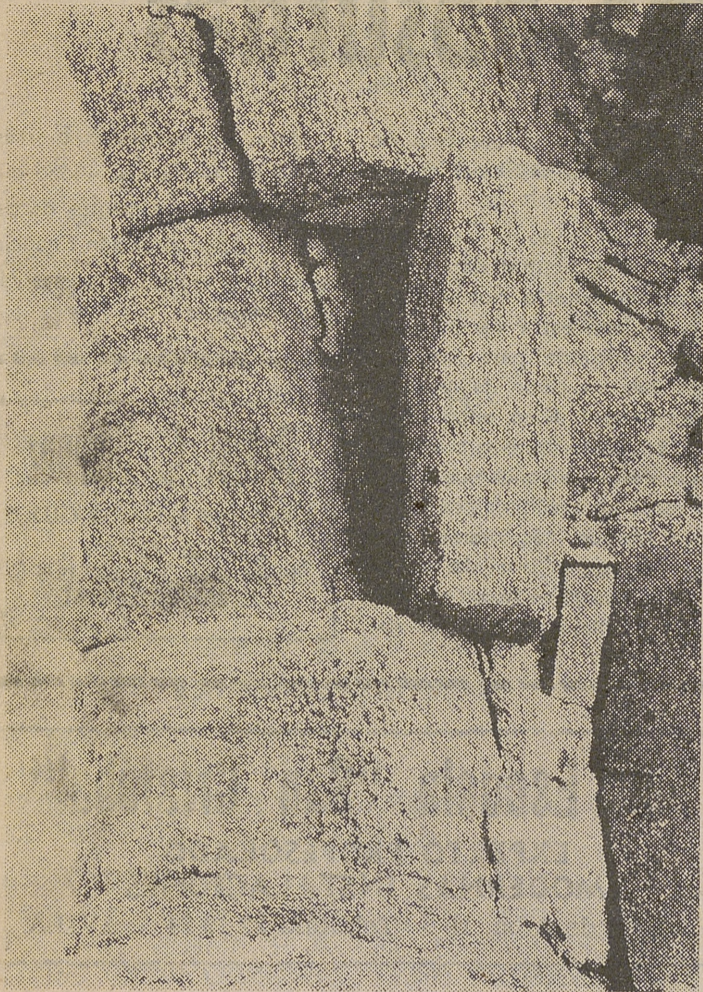
Hace ya casi un año que el Arco del Mariscal se encuentra en las condiciones que se aprecian en la fotografía. El roce de un camión sacó la piedra de su sitio. Primero se apuntaló todo el arco y, posteriormente, se dejó solamente un puntal pequeño en el hueco que deja la piedra. Ahora ya tampoco existe ese puntal, el arco está abierto a la circulación y la piedra amenaza con terminar de caerse en el momento que la toque otro camión. Y, mientras tanto, nadie se ocupa de la oportuna reparación.
