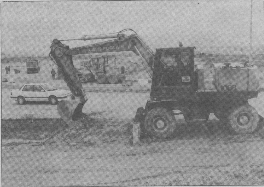
Entre otras obras, Fomento realiza el desdoblamiento de la carretera de La Granja a la entrada en la ciudad.
