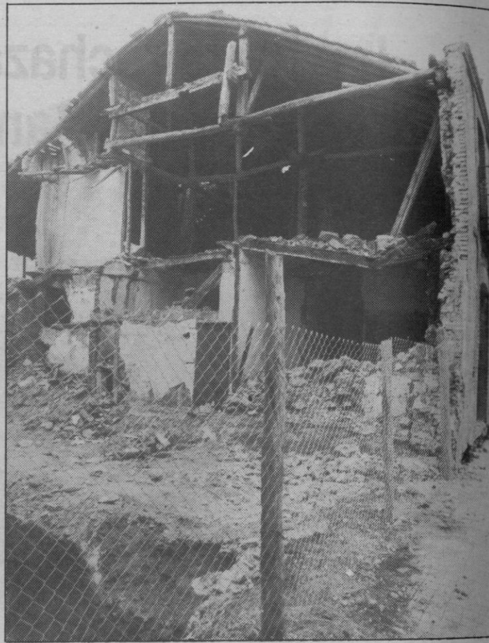
Las termitas acabaron con 32 viviendas de la localidad.
