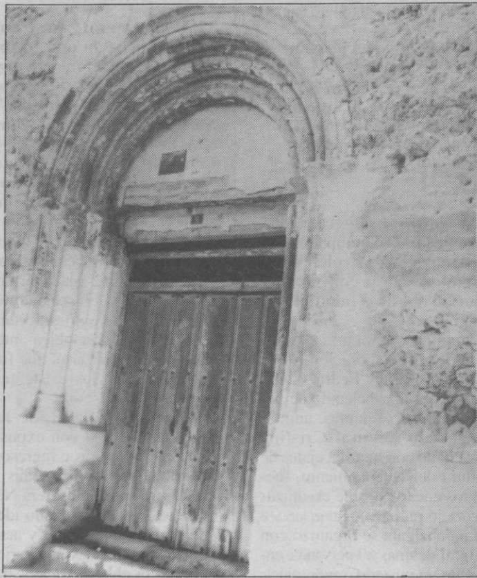
La situación de deterioro del palacio de Pedro I fue noticia.
