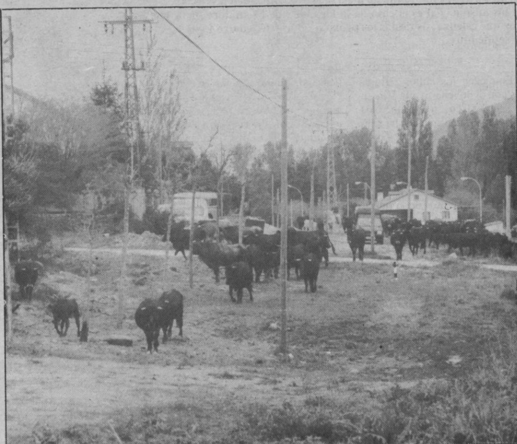
La abundancia de cables aéreos está afectando al entorno paisajístico del lugar.
