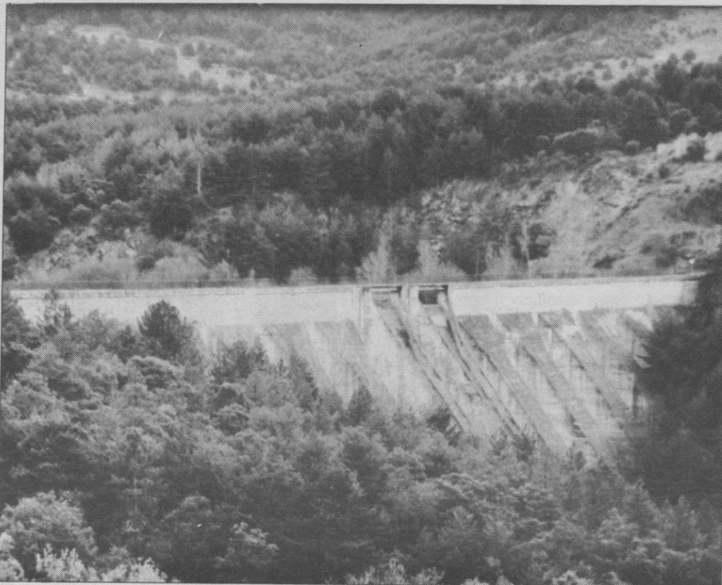
En Puente Alta se pierden ahora entre 10 y 15 litros de agua por segundo.
