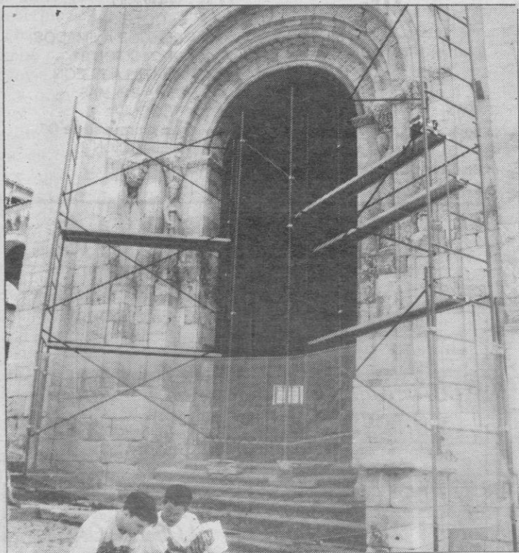
EL MAL DE LA PIEDRA.— El llamado mal de la piedra, debido principalmente a la contaminación atmosférica por los gases de los vehículos y a la lluvia ácida, ataca de nuevo. La bella portada románica de San Martín, que ya sufrió el desprendimiento de una de sus figuras, es ahora la necesitada de andamios. — (Foto: Juan Martín).
