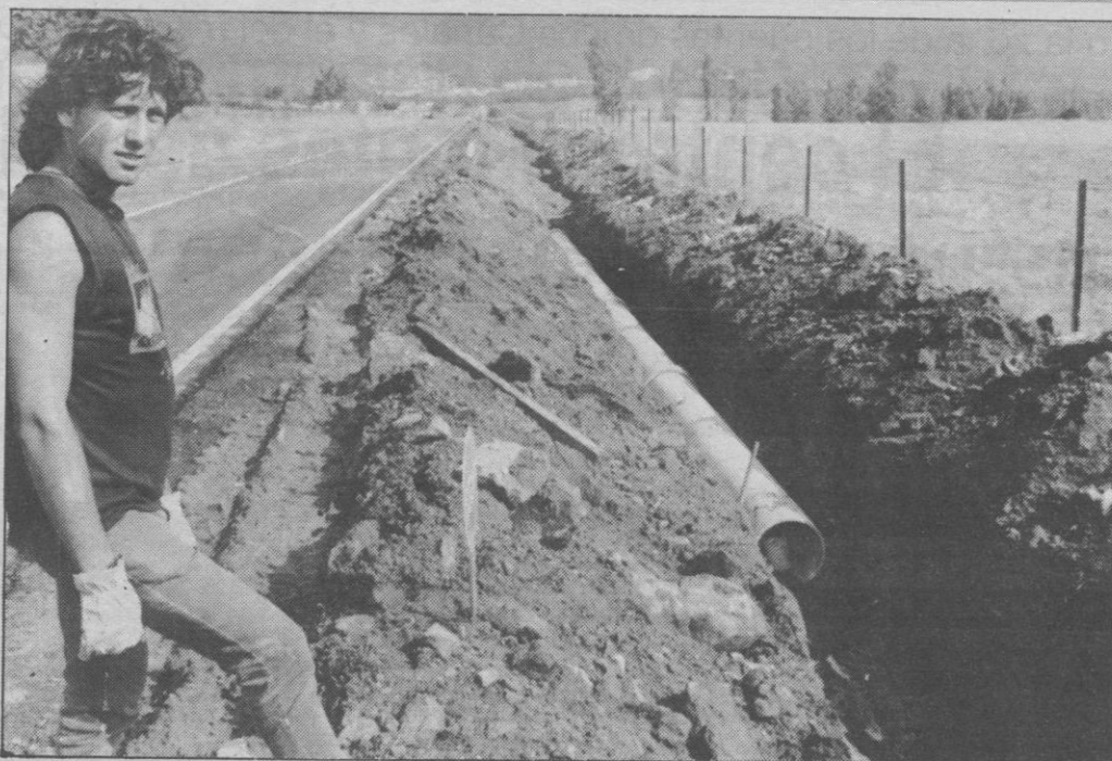
El Ayuntamiento quiere que se compruebe el funcionamiento de la tubería.
