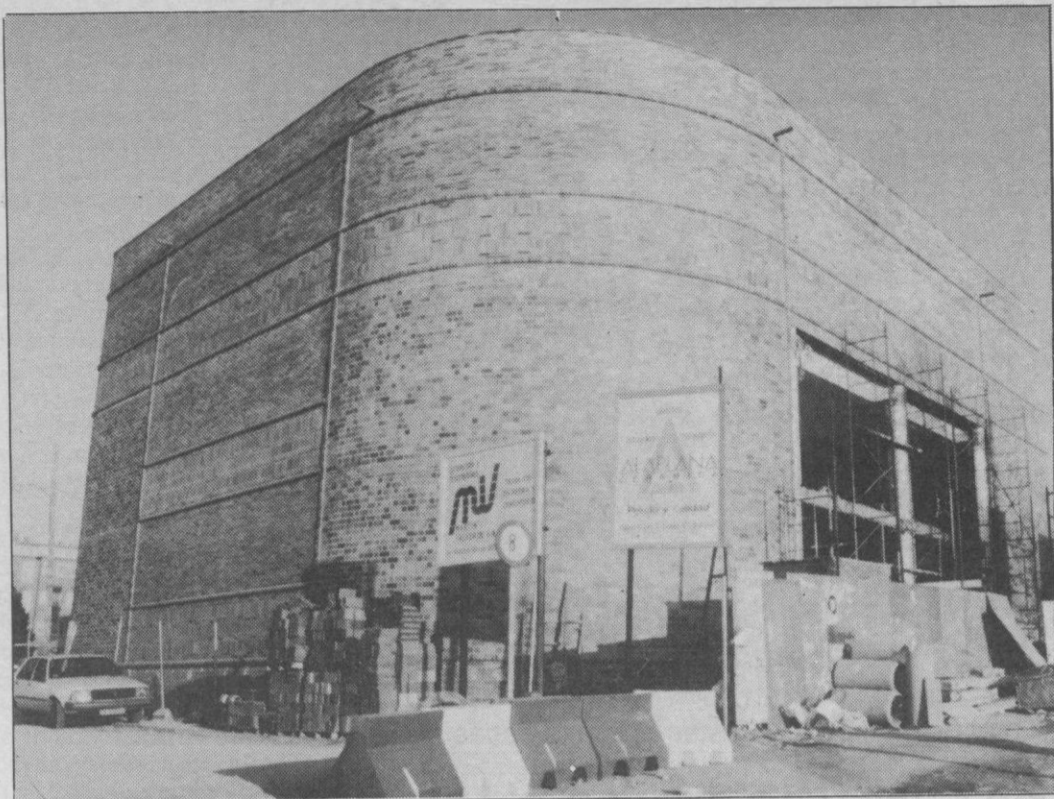
El miércoles se informará sobre el estado de las obras de los aparcamientos del Carmen.
