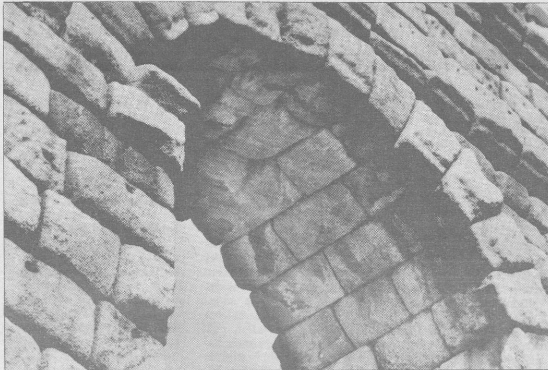
La arquería es la zona más dañada e inestable del monumento.
