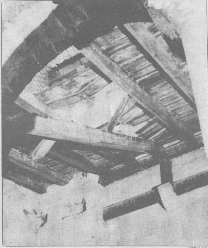
Una considerable parte de la techumbre ya se ha desplomado.
