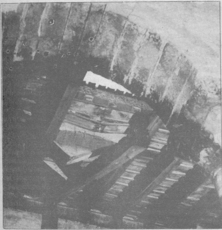
Los daños podrían llegar a ser irreparables
