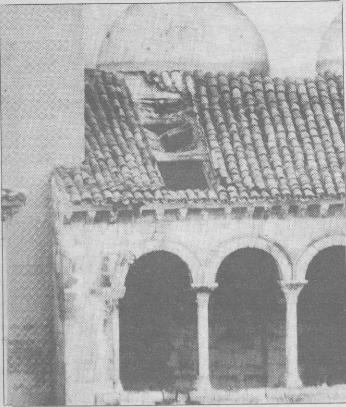
El atrio norte sufre un gravísimo deterioro.
