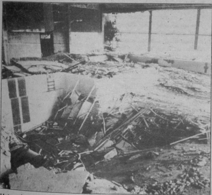
Uster (Suiza).— Destrozos ocasionados en una piscina cubierta en la ciudad suiza de Uster, cercana a Zurich, al venirse abajo la techumbre. Trece personas resultaron muertas y tres heridas. No se conocen por el momento las causas del accidente. (Telefoto Efe/Reuter)
