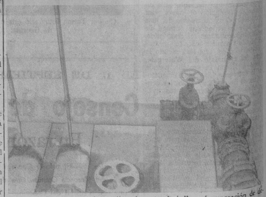
Llaves y tuberías que tienen "mucho que decir" en la operación de depurado, filtrado y clorado de las aguas. (Foto F. Peñalosa)
