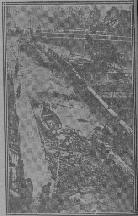
Muro de un muelle de Londres, roto por las aguas en los recientes temporales
