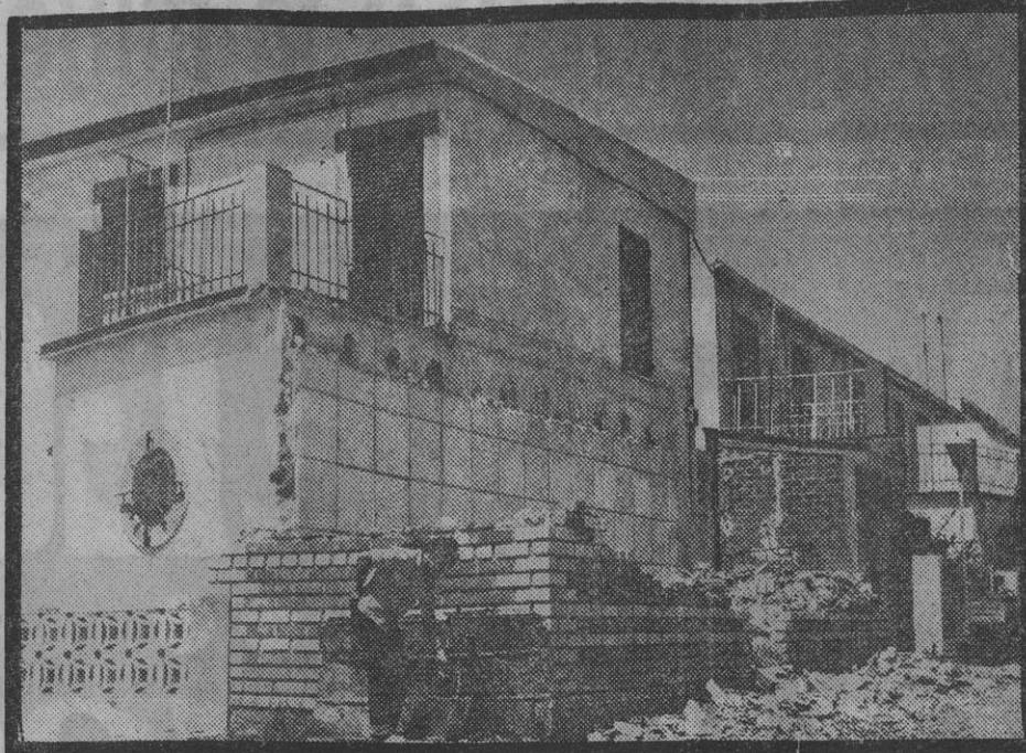
Una de las naves, ya derruidas por orden del Ministerio de la Vivienda.
