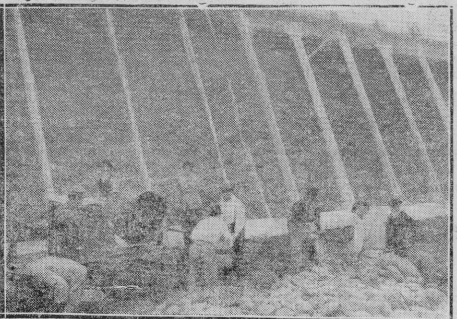
Dos aspectos del estado de las obras de construcción de los depósitos reguladores de agua en Son Togores.
