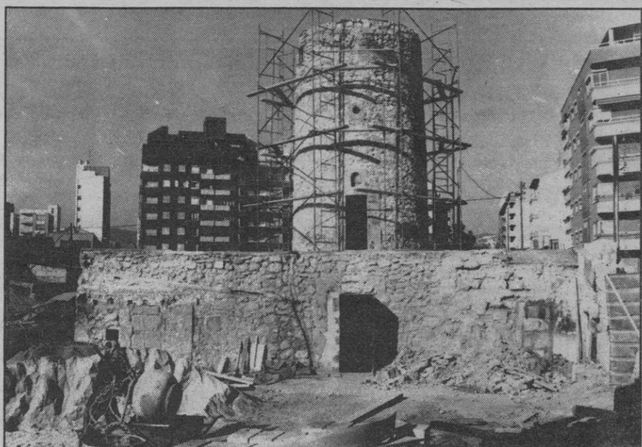
Las labores de reconstrucción continúan a ritmo acelerado, se iniciaron hace ahora un año aproximadamente y finalizarán el próximo mes de marzo.
