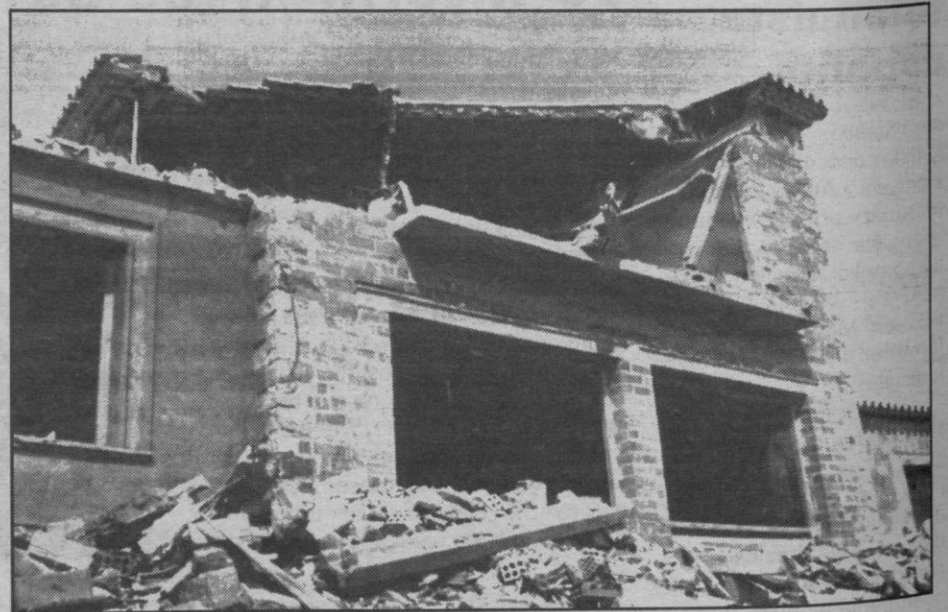
PLAYA DE ARO, (Gerona). El chalet en construcción donde una explosión ha causado dos muertos entre los obreros. Estos dos trabajadores eran enyesadores: (TELEFOTO EFE)
