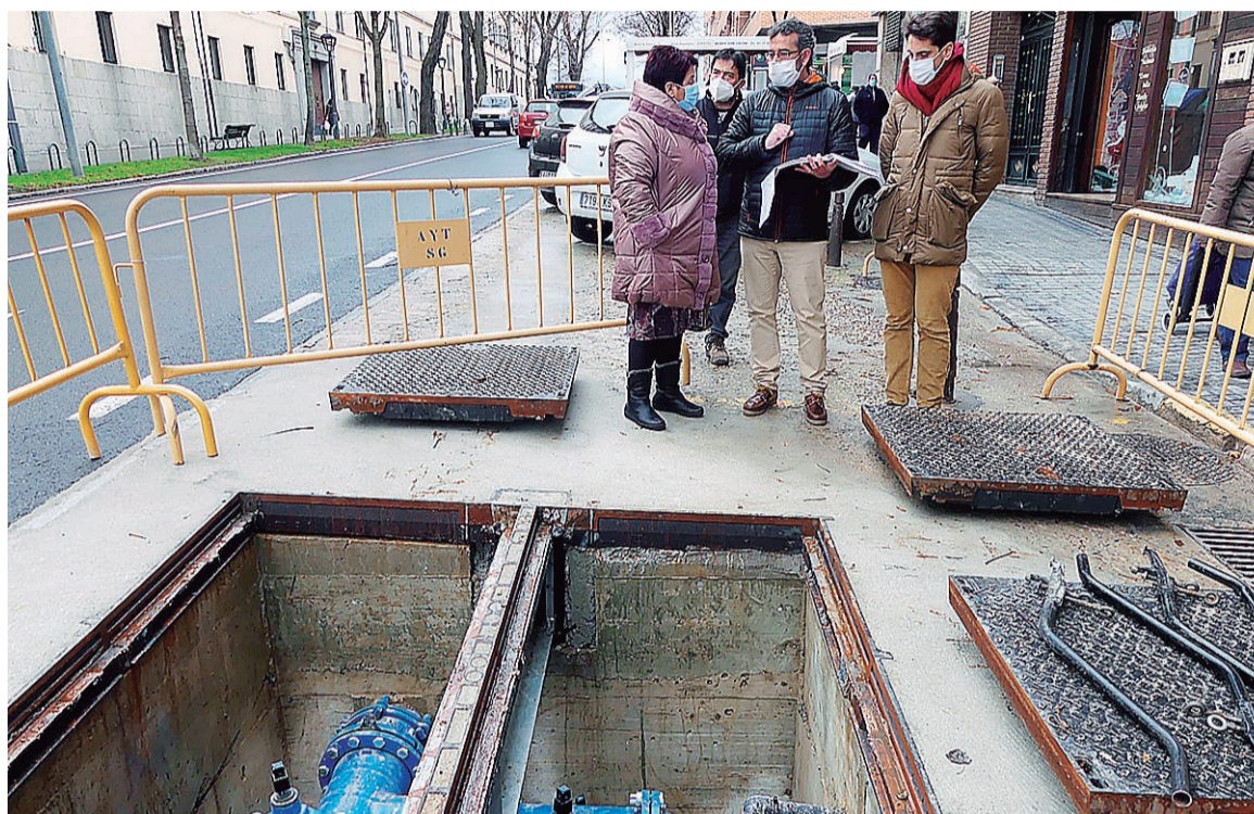
La alcaldesa y el concejal de Obras, Miguel Merino, comprobaron la finalización de las obras en Juan Carlos I. E. A.
