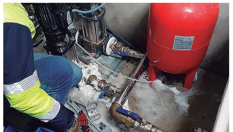
Instalaciones del depósito general, completamente congeladas.
