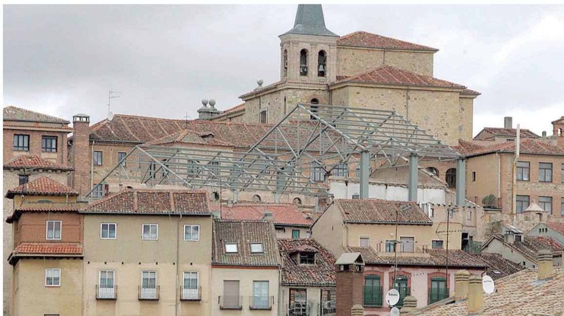
La estructura metálica de la cubierta motivó la paralización de la rehabilitación en 2007 por exceso de volumen.
