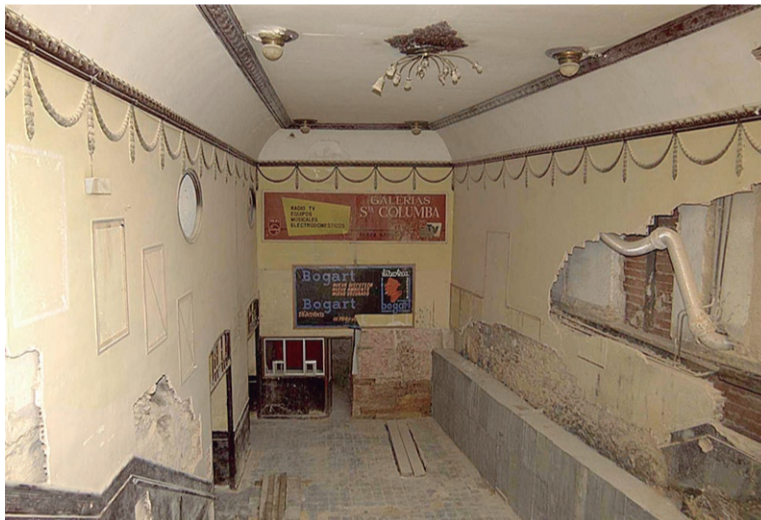
El vestíbulo de entrada y la taquilla desde la escalera de acceso.
