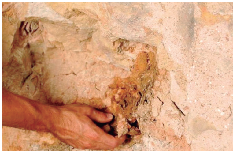
Paño de la Muralla en mal estado por la humedad.
