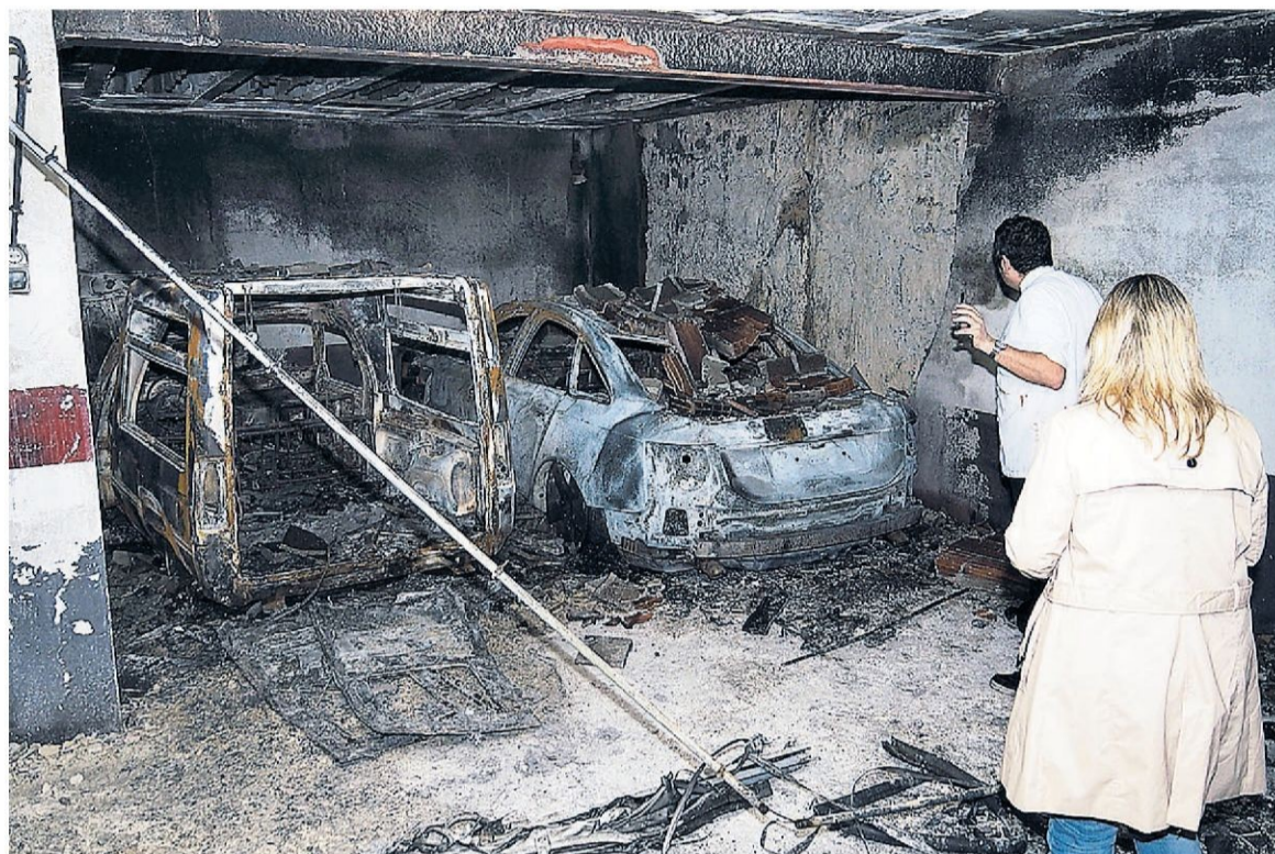
Estado en el que se encontraban la furgoneta que ocasionó el incendio y un coche anexo.
