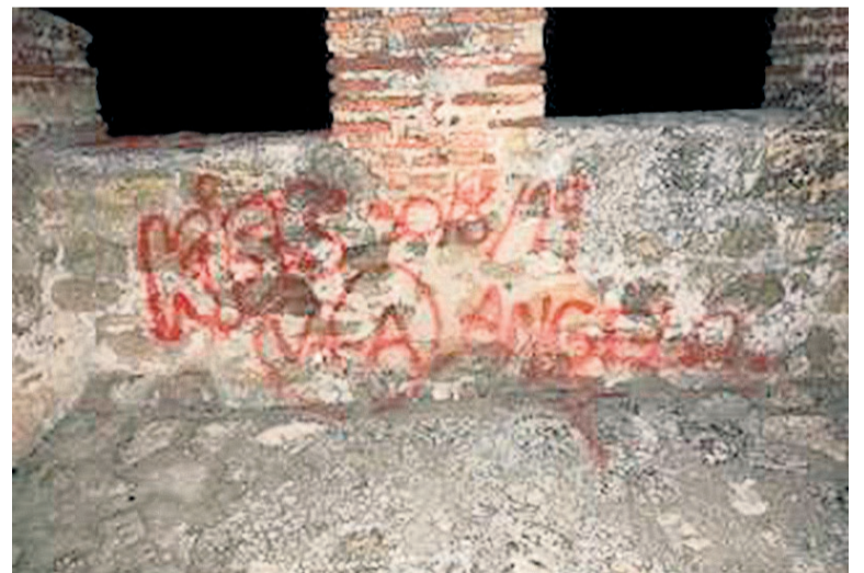
Una de las pintadas realizadas en el adarve de la muralla.
